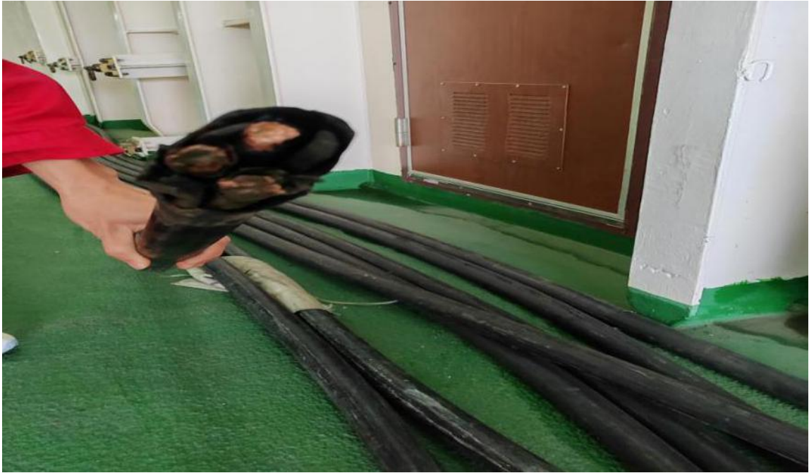
图9. “N” 轮380伏岸电电缆断裂图
